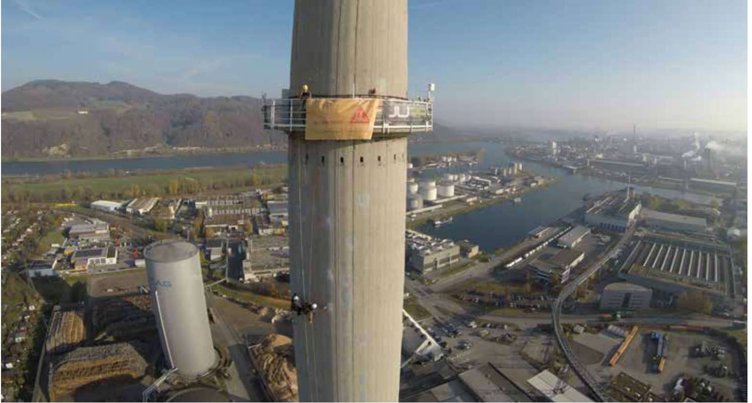
Bild 1: Lokalisierung und Dokumentation der Schadstellen des 183 m hohen Kamins
