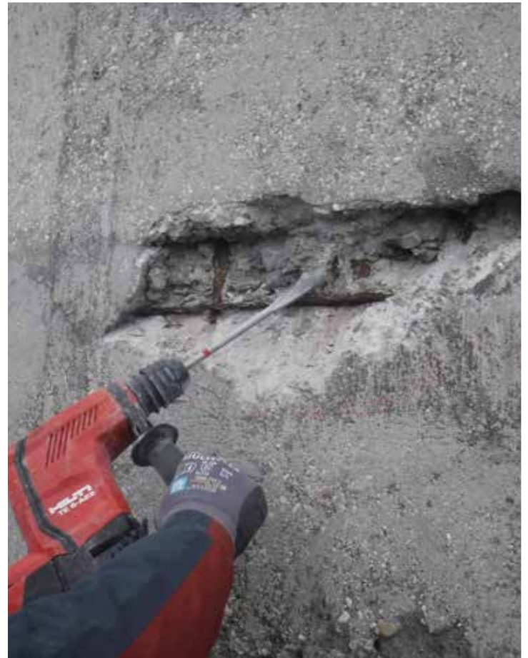
Bild 3: Freistimmen der schadhaften Flächen
